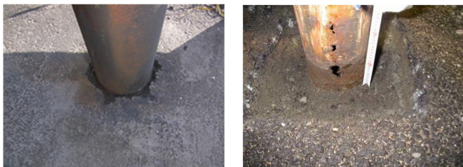
(腐食，路面付近での滞水や錆汁)
