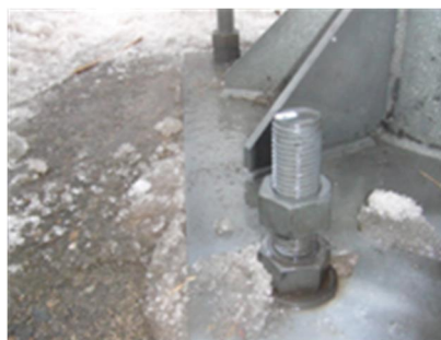
図－6．1 設置後1年程度の附属物のアンカーボルトのゆるみ
