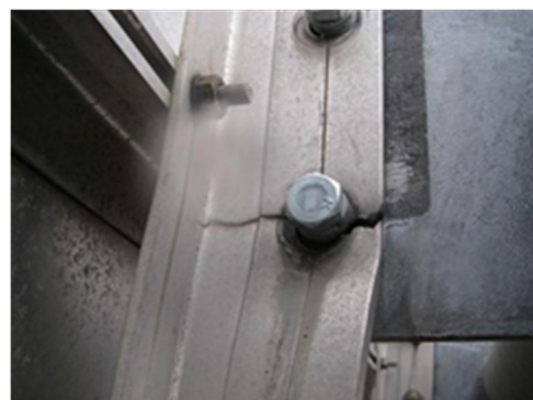
取付部の変状状況
