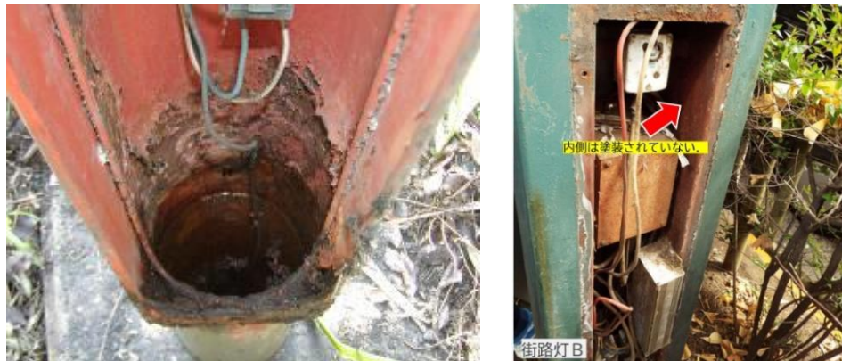
図－２．１．４ 電気設備開口部の損傷例
