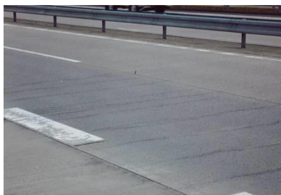
(連続鉄筋コンクリート舗装で健全と診断される横断ひび割れの例)
