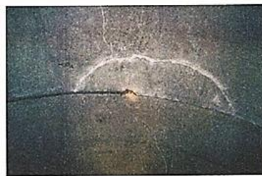
写真 7-2 半月状のひび割れ
